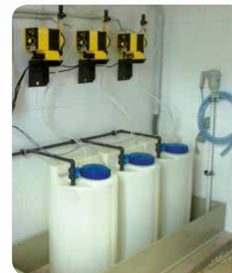
Servicii de apă și canal – transvazare hipoclorit de sodiu
