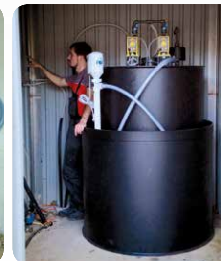
Stație de apă uzată – transvazare hipoclorit de sodiu
