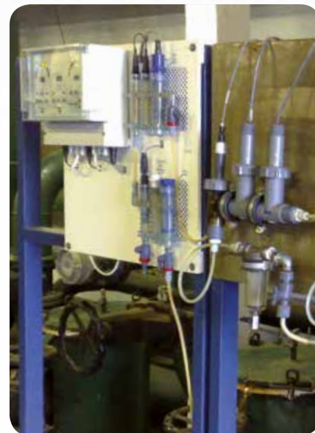
Sistem de control și măsurare a clorului, pH, Redox în piscină
