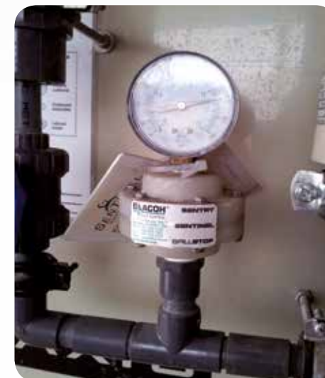
Stațiune de adăugare chimicale: - manometru separat
