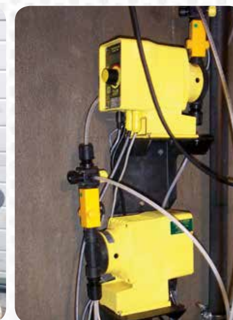
Tratarea apei din piscine-adăugarea peroxidului de hidrogen
