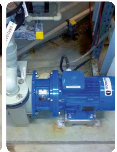
Transportul apei uzate din centrală
