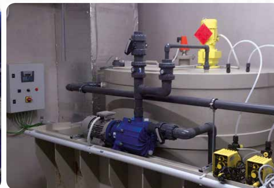
Laborator farmaceutic industrial- neutralizarea apei uzate
