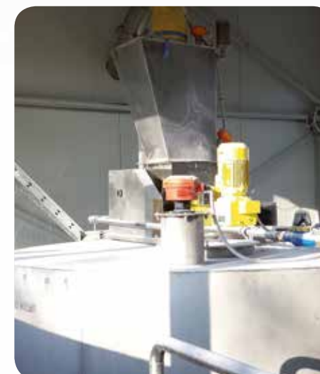
Măsurarea nivelului în dozător de pulbere
