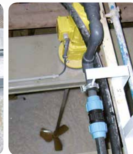
Fabrică de detergent: tratarea apei uzate cu agitator
