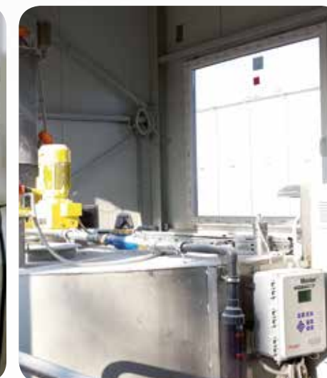
Neutralizarea apei uzate industriale (aparat WIND)
