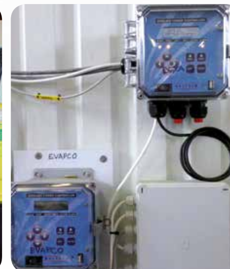
Fabrică de apă minerală - turn de răcire (aparat WCT)
