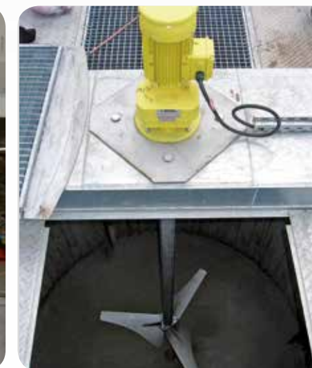
Fabrică de medicamente: tratarea apei uzate
