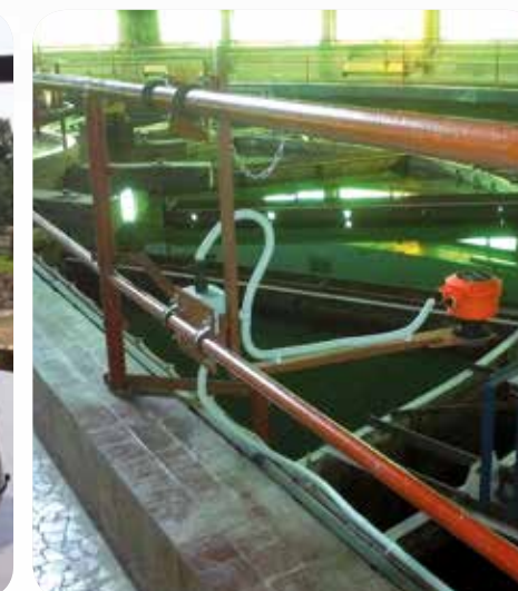
Centrală: măsurarea nivelului
