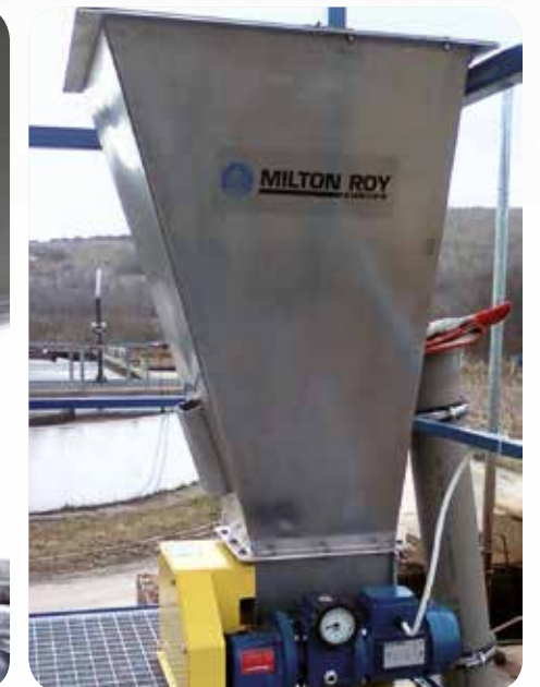
Uzină de apă: adăugarea hidratului de calcar
