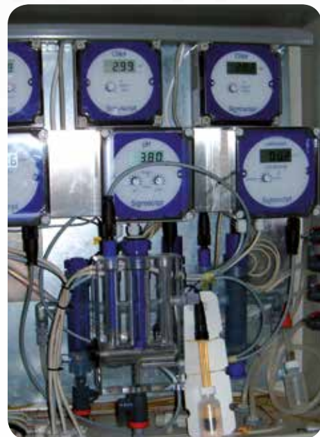
Fabrica de detergent-măsurarea pH-ului și a clorului
