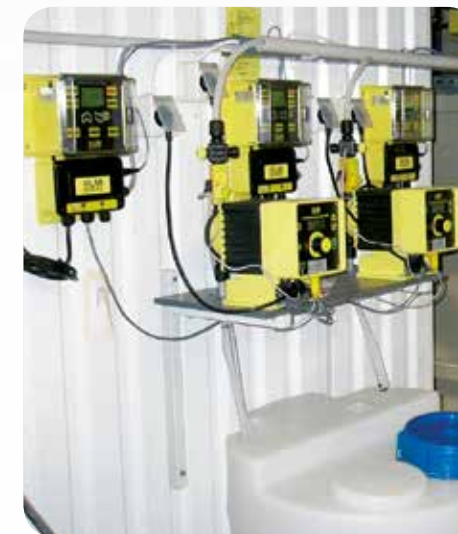
Neutralizarea apelor uzate: -dozarea acidului sulfuric
